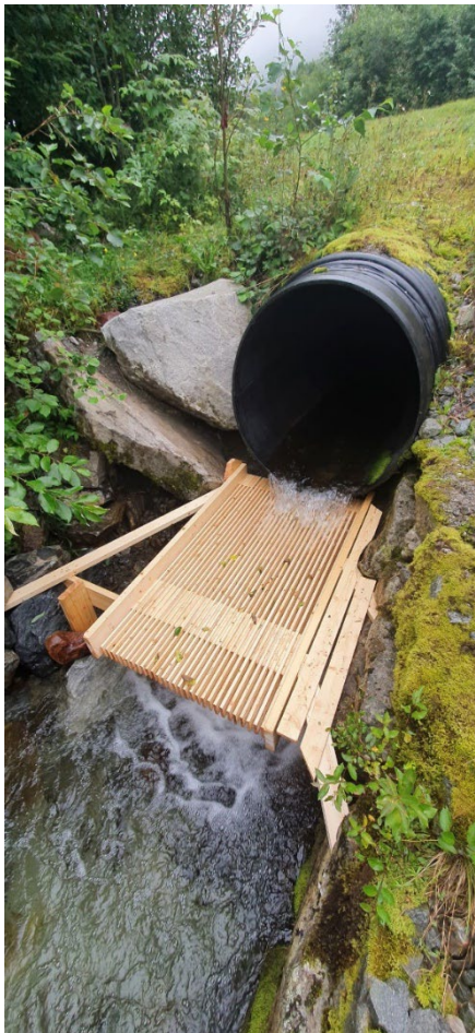
Figur 16. Kulvert i Fagerbekken under Sunndalsvegen etter montering av oppgangssperre.
