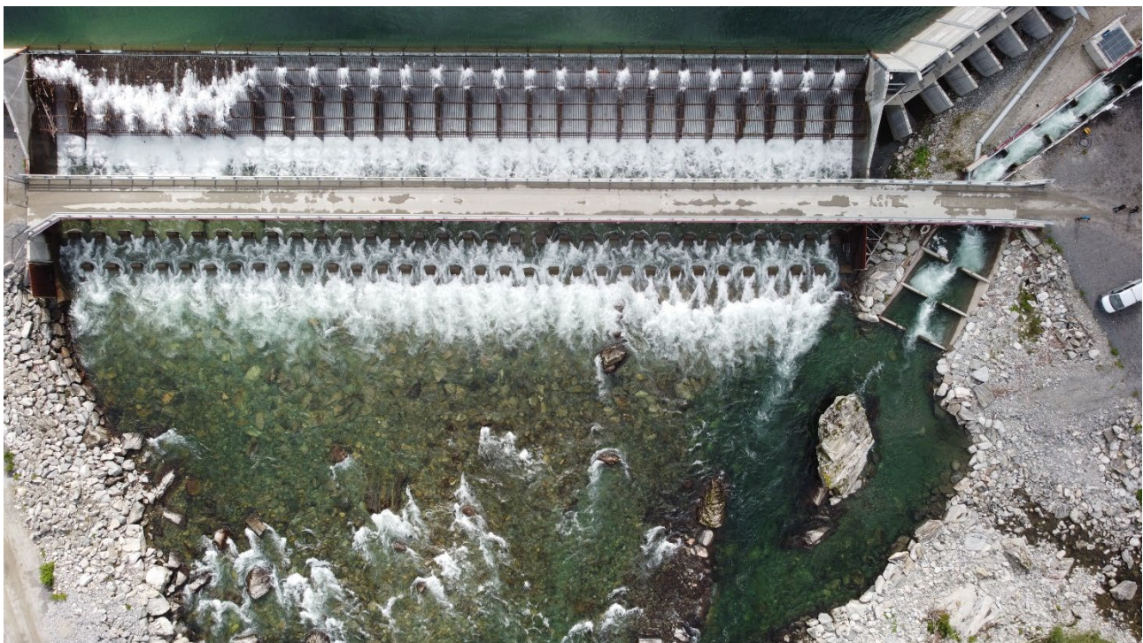
Figur 19. Sperra i Driva med fisketrappa til høyre i bildet. Vannet var stengt av i trappa under bekjempelsen, og kammer med stillestående vann i og utenfor fangsthus, samt vann i betongkammer langs foten av sperra (øverst til høyre i bildet), ble rotenonbehandlet. Foto: Anders Hagen, NIVA.
