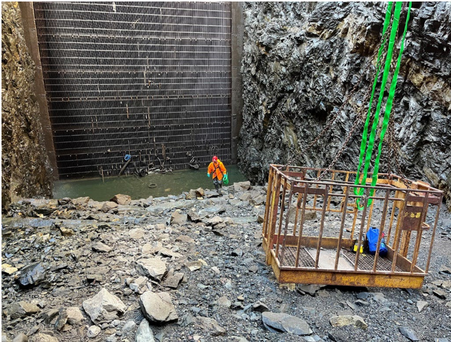
Figur 4. Øvre basseng foran rist inn til turbinen. Foto: Svein Aune.
