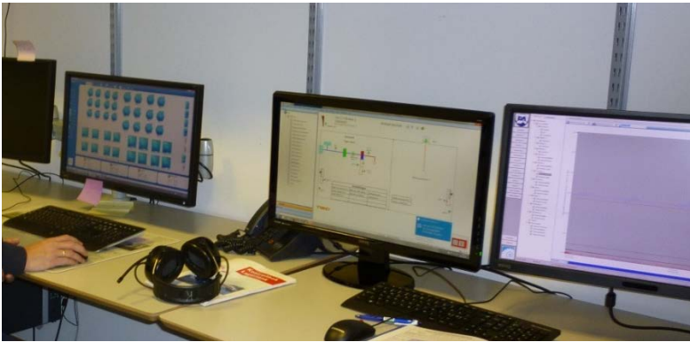
Figur 19. Overvåkingsrom på settefiskanlegg
