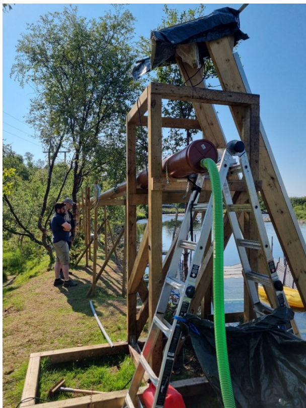
Figur 7.5. Starten på den 85 meter lange rørgaten i Vestre Jakobselv. Pukkellaksen heises opp fra slaktebenken nede til høyre, og tømmes inn i røret. For at pukkellaksen skal gli nedover til de ventende iTub-kassene, ble det i tillegg pumpet vann inn i røret. (Foto: Egil Liberg)
